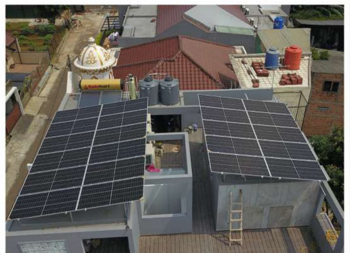
@ Bekasi - 15 kW On Grid
